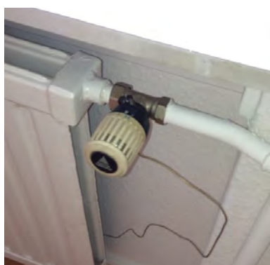
Gl. radiator og termostat
